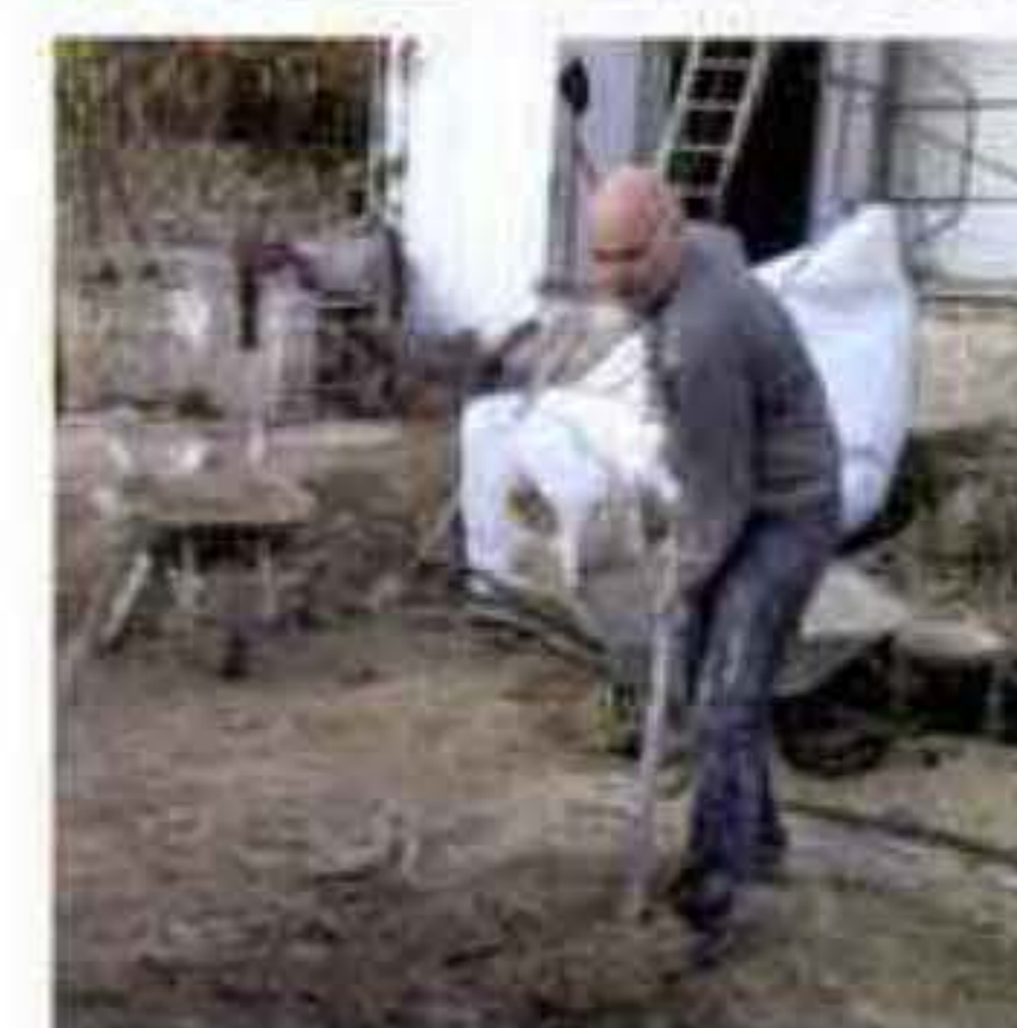
Philippe et Christophe ont beaucoup œuvré à toutes les étapes du chantier.
